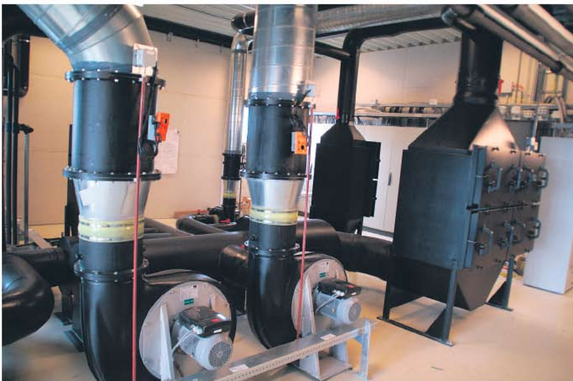
De goed gevulde installatieruimte van het radiologisch laboratorium.
